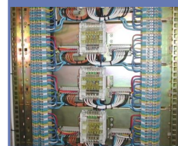
Saídas por Terminais
